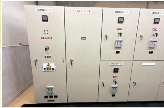
工事名 県立図書館本館受変電設備更新工事 規模 県立図書館における受変電設備更新 高圧受電盤（1面）、高圧コンデンサ盤（1面）、図書館電灯盤・動力盤（1面）、文書館電灯・動力盤（1面）、非常電灯盤・非常動力盤（1面） 施工会社 株式会社中電工 鳥取統括支社
